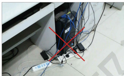
插线板需固定，不宜直接置于地面
